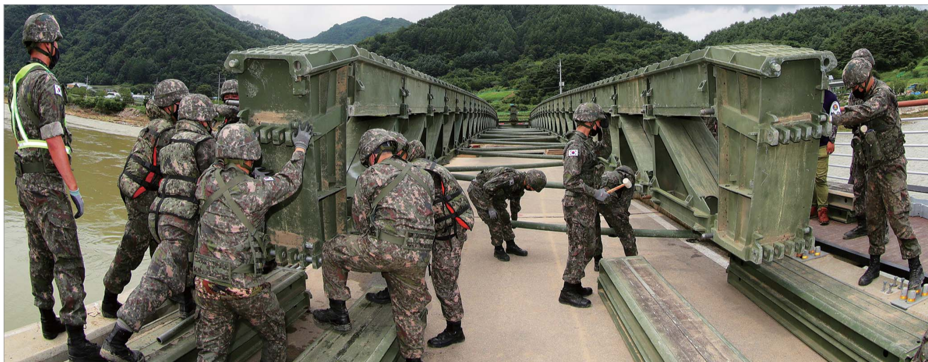
12일 육군3군단 공병여단 장병들이 최근 집중호우로 마을과 외부에 잇는 양지교 상판 일부가 내려앉으면서 고립된 지역 주민들을 위해 군 작전용 교량인 '간편조립교'를 구축하고 있다. 인제=조종원 기자
